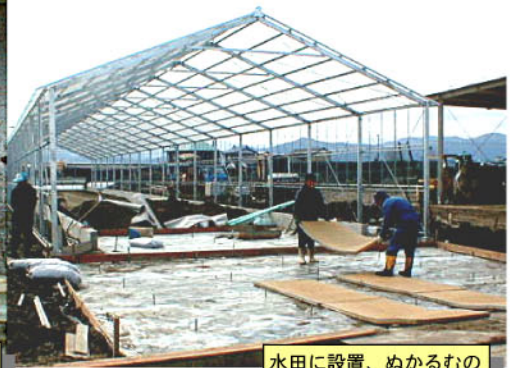
水田に設置、ぬかるむので畳を設置している
